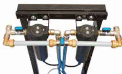
Detail obchozího potrubí
